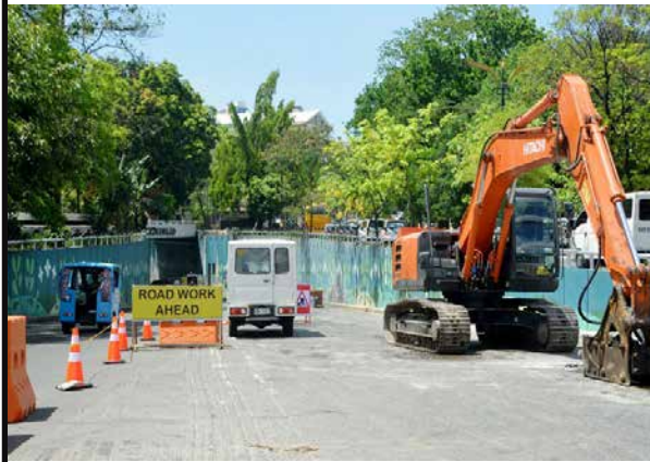
ITO ang Lagusnilad Vehicular Underpass sa Maynila at kalahati ng bahagi nito ay isinara para sa rehabilitasyon na sinimulan noong Mayo 2 at tatagal ng apat na buwan o hanggang sa Setembre ang naturang rehabilitation project na pinondohan ng P50-M ng lokal na pamahalaang lungsod. Si Manila Mayor Honey Lacuña ang nanguna sa kick-off ceremony kamakailan. CHRISTIAN HERAMIS
